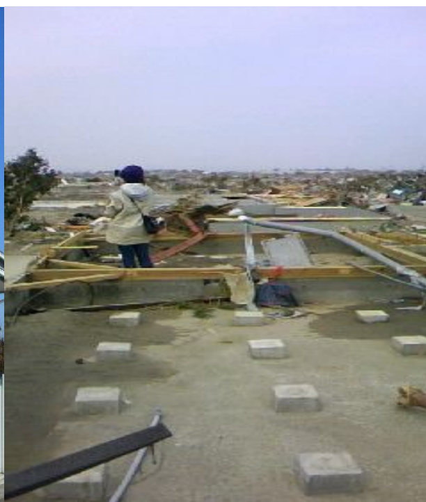
被災後 2011.3.25 撮影 基礎のみ残る
